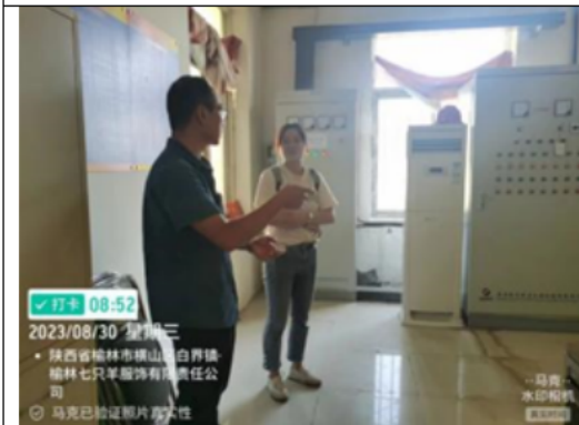
在榆林区汇通服务站羊老大供热站开展实地调研及访谈，了解供热设备运营管理问题
