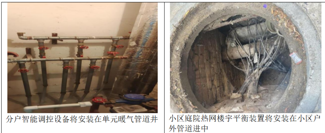
图 7-3 小区庭院热网楼宇平衡装置及分户智能调控系统安装地示例
