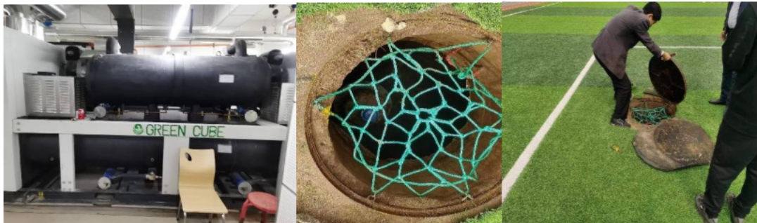
图 4-2 西安市新城后宰门小学（幸福校区）热泵机房和换热井孔
