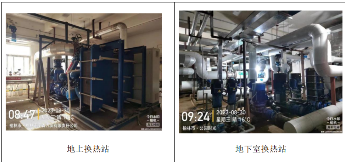
图 2-1 小区/单位换热站典型照片
